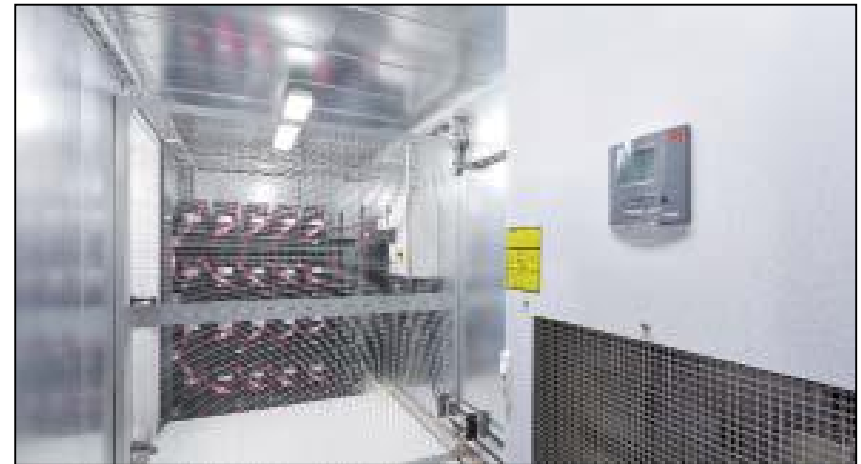
ESI-I and batteries
